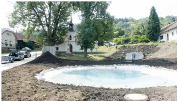
Úprava návsi v Mladkově se chýlí ke konci. V současné době odborná firma provádí zemní práce. Foto Jaroslav Oldřich
